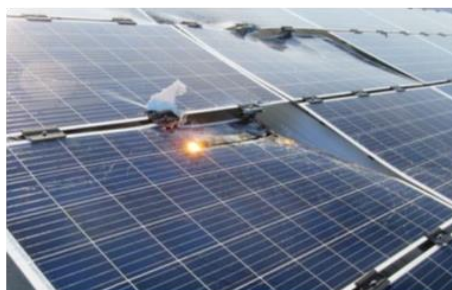
台風により破損したパネルの発火
