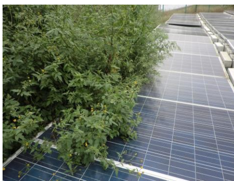
6-21 雑草によりモジュールに影がかかっている例
