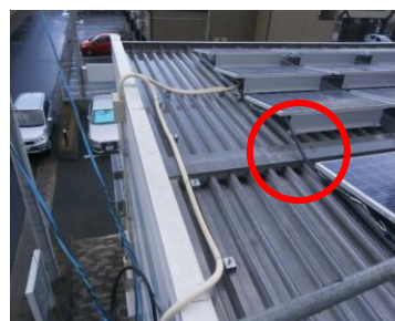
写真 6-14 露出部に保護管が設置されていない（赤線部分）
