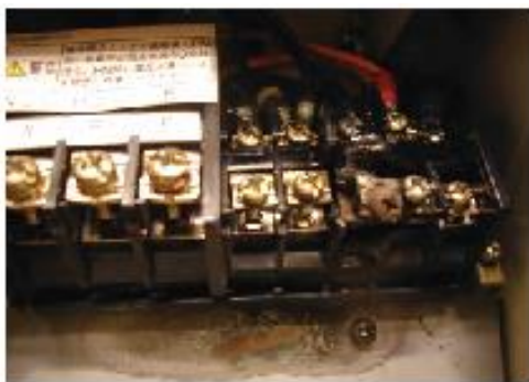
写真 6-16 24 端子部の焼損
