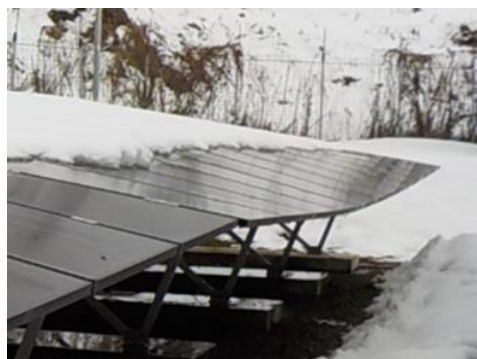
写真 6-7 21 雪による変形
