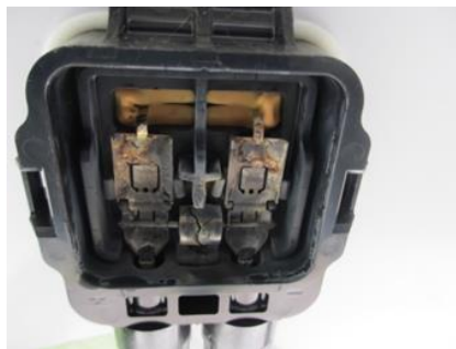
写真 6-19 27 モジュール裏面バイパスダイオードの故障
