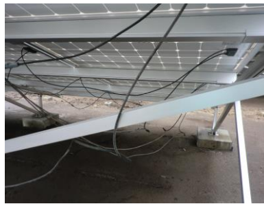
写真 6-12 配線の結束不良
