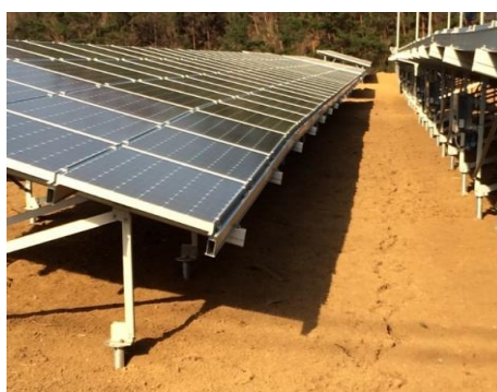
写真 6-8 地盤沈下による変形（不陸）
