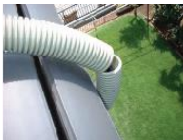
写真 6-13 保護管の一部破損 22
