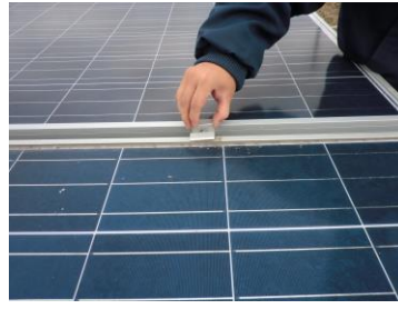
写真 6-10 抑え金具の緩み
