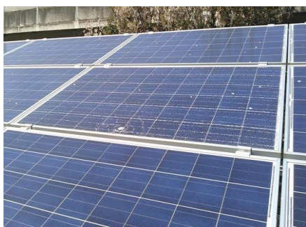
写真 6-1 ひび割れ（落下物）
