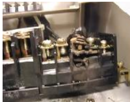
写真 6-17 25 端子部の焼損
